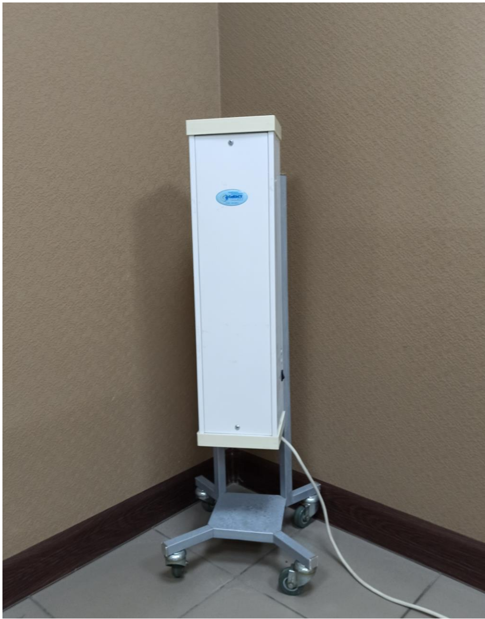
Все рабочие помещения обеспечены бактерицидными лампами
